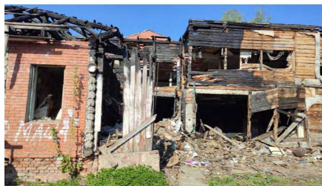
Заброшенный после пожара торговый центр «Лавки» по пер. Карповскому, д. 6 ст. 1 (снесен осенью 2023 г.)
